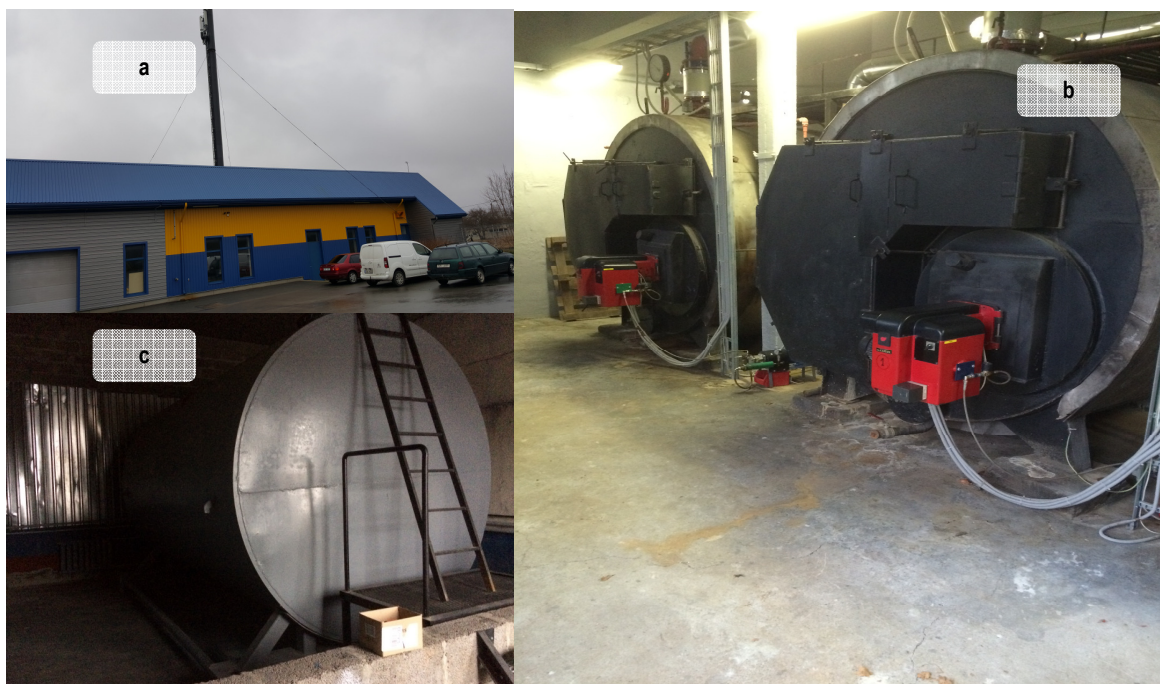
Joonis 3.1.2 – a). Lehtmetsa katlamaja hoone, b). Lehtmetsa katlad (Kaks identset katelt Põlevkivi-80), c). Lehtmetsa Kütusemahuti 25m 3
