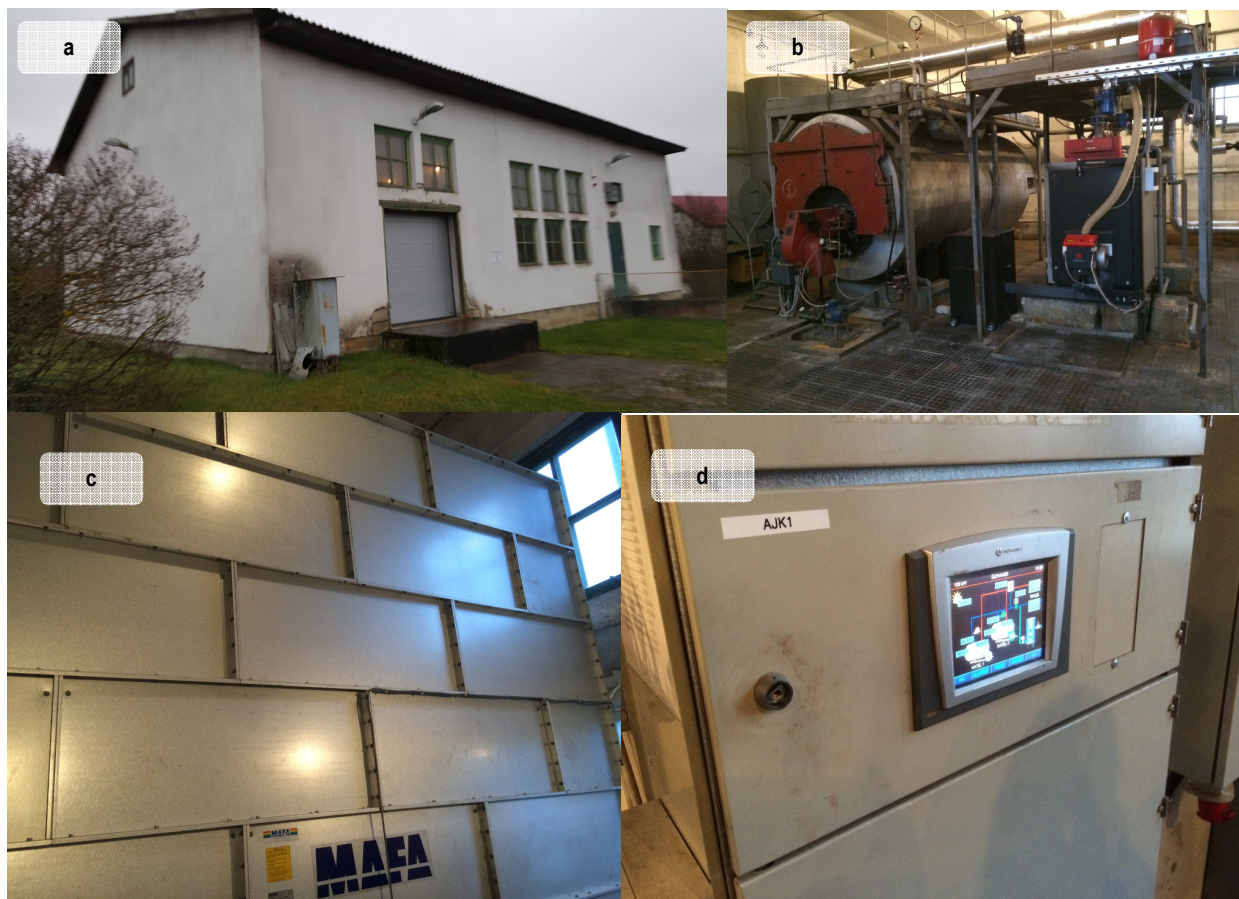
Joonis 3.1.3– a). Alavere katlamaja hoone, b). Alavere katlad (Futer-2 ja Vitoplex 200), c). Pelletipunker (21,3 m 3 ), d). Automaatikasüsteem
